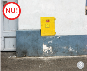
ASA NU: Instalațiile edilitare ies în evidență în contrast cu materialele și culorile specifice construcțiilor tradiționale. Pavajul impermeabil (ciment sau asfalt) împinge umiditatea solului în zădire și o degradează.
