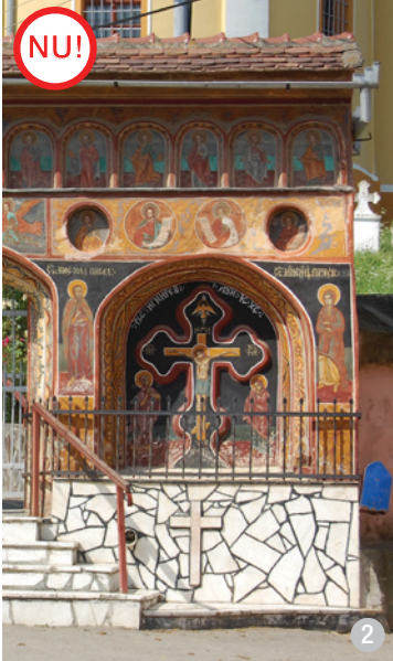
ASA NU: Placarea fundației cu orice tip de material impermeabil afectează imaginea construcției, dar mai ales sănătatea acesteia: umiditatea din sol nu se mai evaporă la nivelul soclului, ci este forțată să urce prin perete la înălțimi mai mari.
