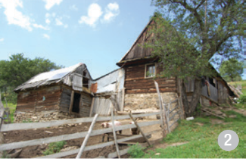
Colibă și anexă cu pereți din bărne de lemn. Din păcate, învelitoarea nu a fost întreținută corespunzător, ci completată cu materiale nespecifice zonei: prelate din material plastic și tablă zincată.
