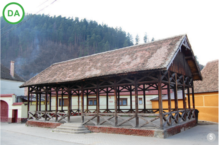
ASA DA: Pavilion pentru fanfară sau alte evenimente ale comunității locale. Din păcate, soclul și treptele de acces au fost reparate cu soluții incompatibile.
