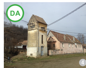
AȘA DA: Stație electrică de transformare, care prin volumetrie, finisaje și culoare se încadrează în specificul local (Richiș, jud. Sibiu)
