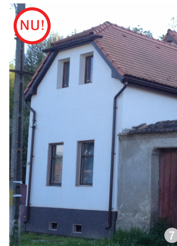
ASA NU: Modificarea gurilor de aerisire nu este permisă în vederea amplasării unor ferestre. Aceasta aduce grave modificări aspectului general al fațadei. (Richiș, jud. Sibiu)
